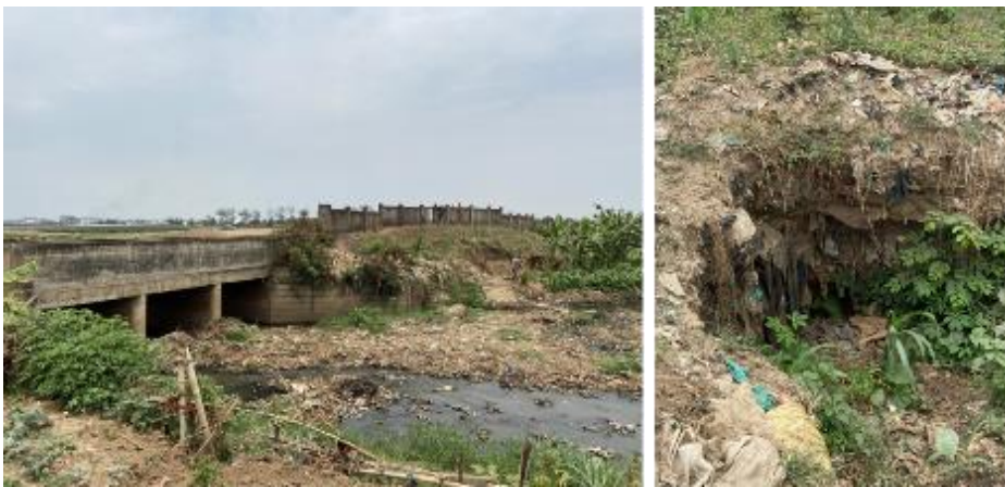
Près de la station d'épuration de Ntakangwa - débris anthropogéniques recrutés par l'érosion des berges et l'évacuation directe dans le canal (Photo : Paul Sayers, Oct 2022)
